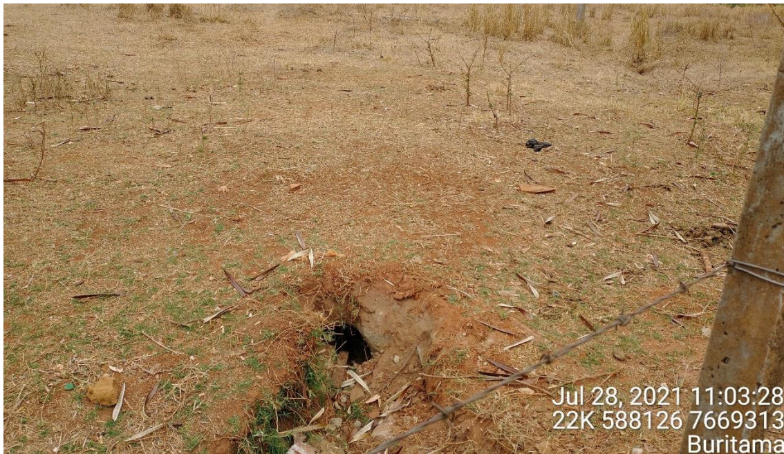
Figura 11 - Abertura na tubulação existente ao final da Rua Elias Jose Abdo
