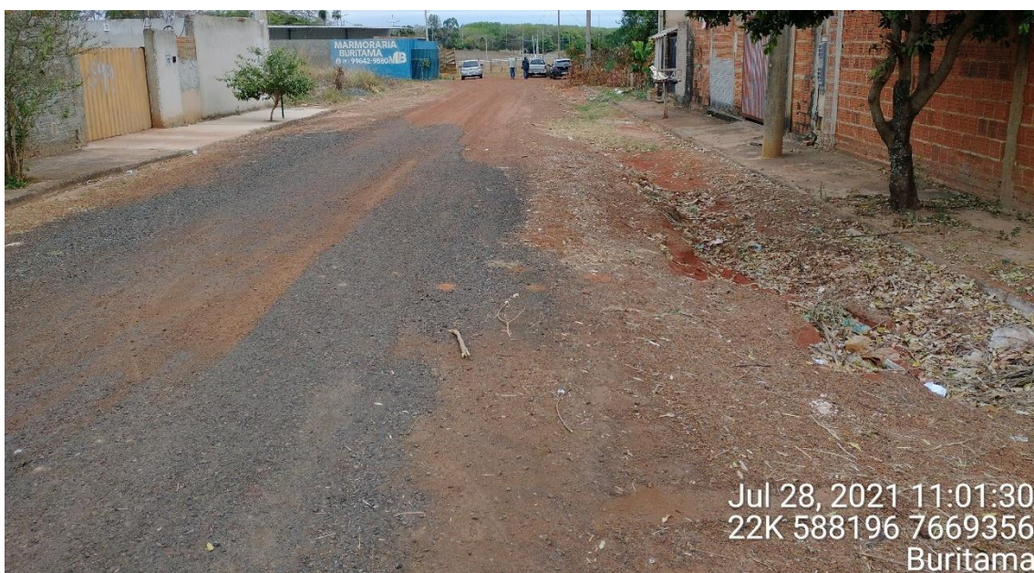
Figura 10 – Pequenas erosões laterais causadas pelo escoamento na Rua Elias Jose Abdo
